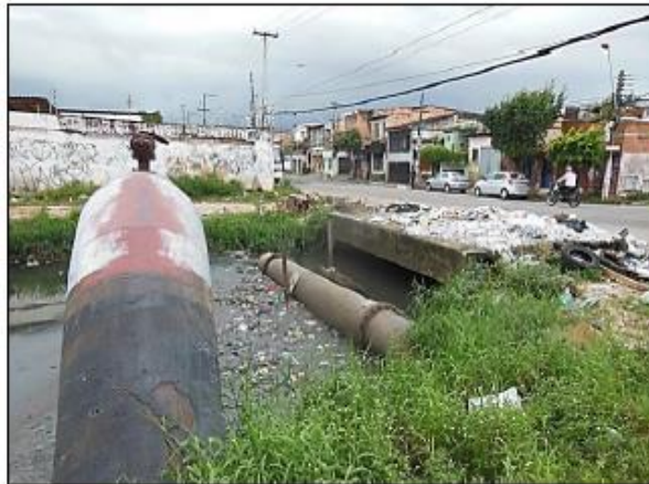
Figura 51: Descarte irregular de resíduos na avenida Gal. Teodoro/Av Eng. Fernando Guilhon.
